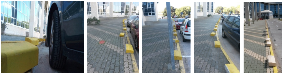
1.1 (el bloque invade espacio de la calzada) 1.2 (bloque desplazado acera lateral CASEM) 1.3(bloque despegado) 1.4(bloque desplazado) 1.5 (bloque despegado en otra zona del CASEM)
